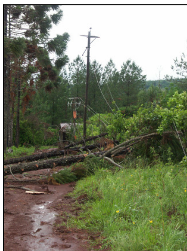
Unsere ramponierte Stromzufuhr
